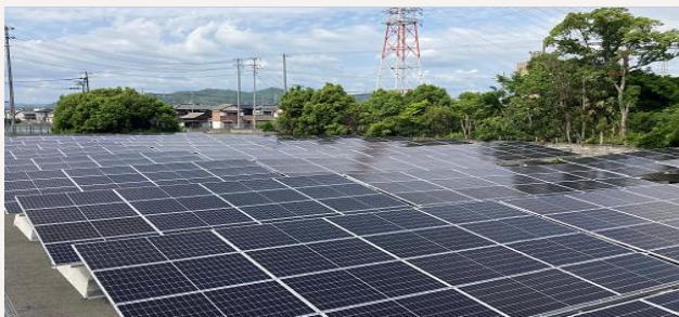
(当社専用のオフサイトの太陽光パネル 資料提供：関西電力)
